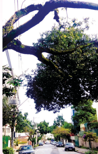
Árvore na rua Pousa Alegre, próxima a Escola Estadual Sandoval de Azevedo mostra sinal que está inclinada. Fica o alerta para que a PBH faça uma vistoria
